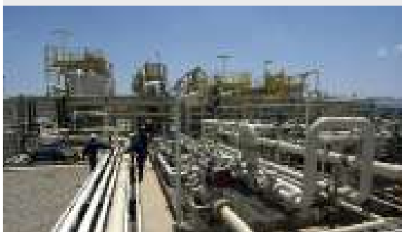
Emirates Gas, UAE
